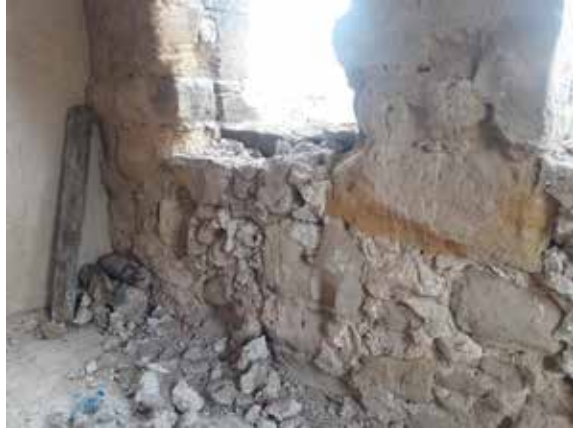
Estado previo de la espadeña por dentro.
